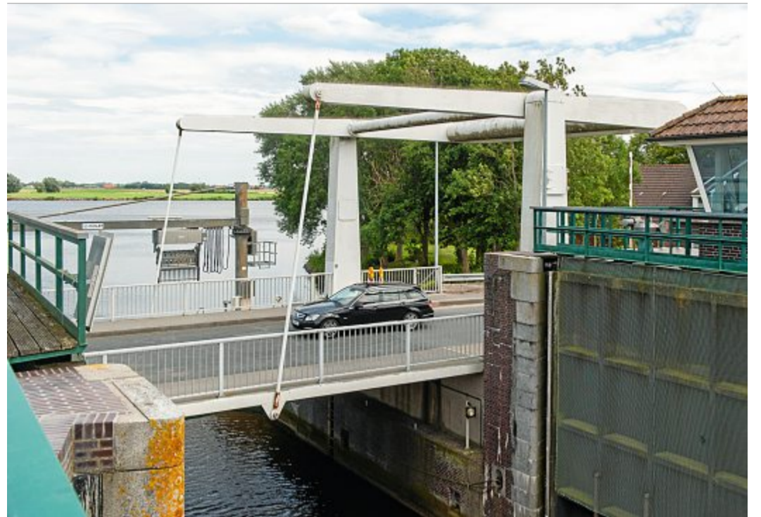
Die dringend erforderliche Sanierung macht eine Vollsperrung der Klappbrücke Leybuchtziel erforderlich. FOTO: BRUNS
