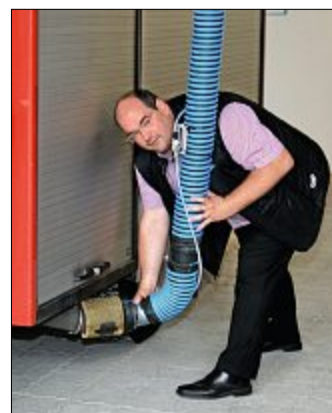
Ortsbrandmeister Björn Bittner an der neuen Abgasabsauganlage. FOTO: PETERS
